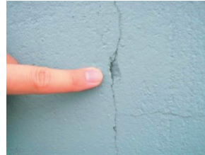
外壁のひび割れ
